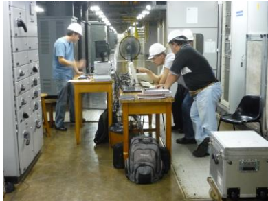
Ensaios de levantamento de parâmetros do gerador
